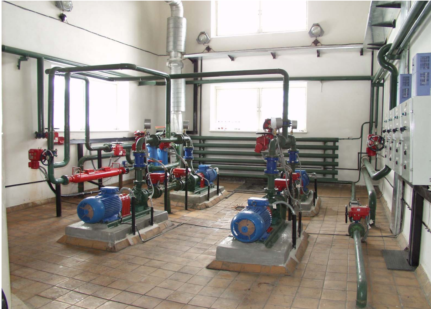
Общий вид установки
